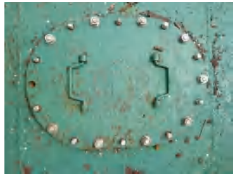
生活污水储存仓
