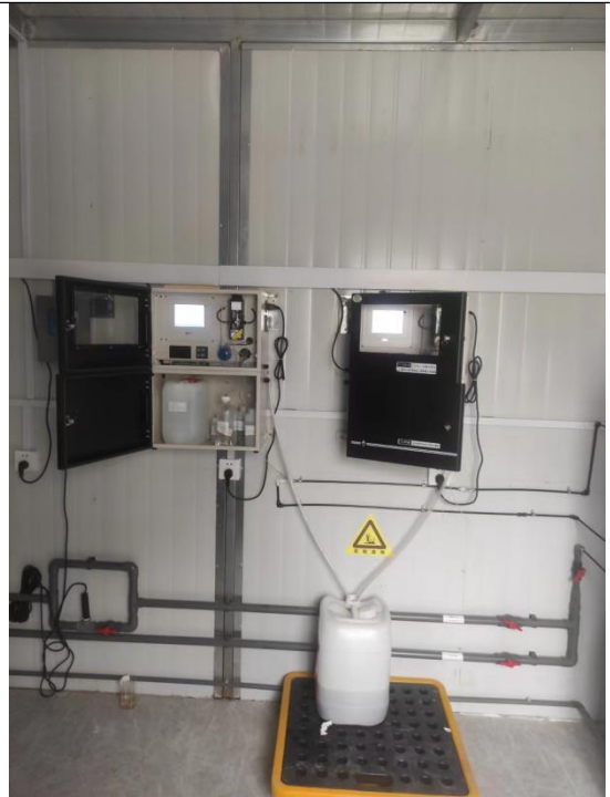
污水在线小屋
