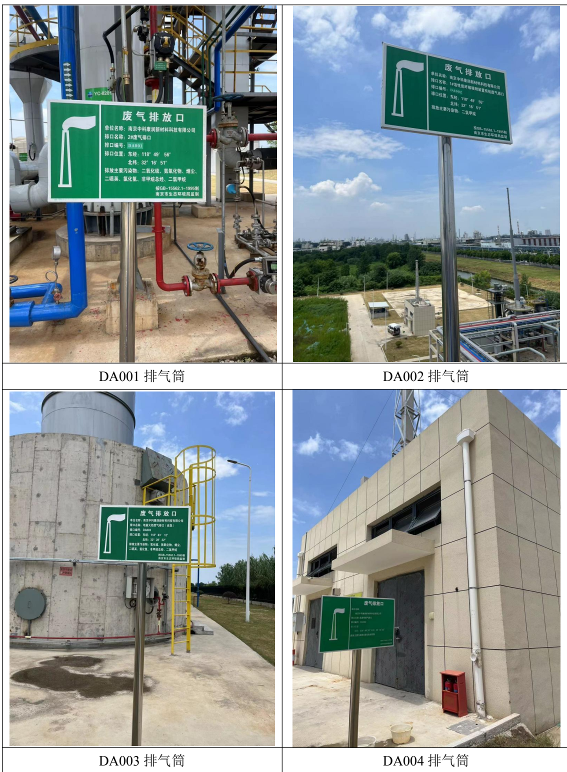
图 4.2-2 废气排口环保标识牌
