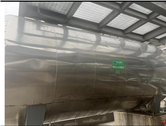
原料二氯甲烷储罐
