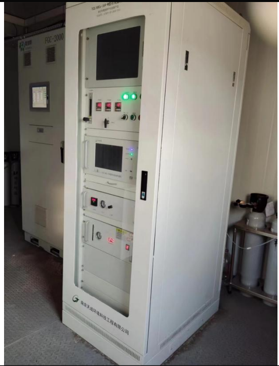
TO 焚烧炉废气在线小屋
