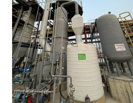
废碱液收集罐
