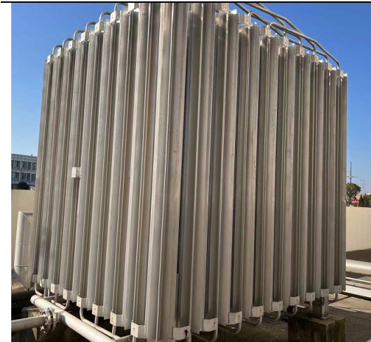
储罐增压气化器
